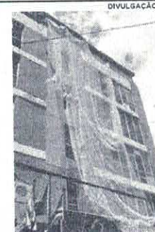
Reforma em fachada de prédio causa incômodo e leva perigo para moradores do São Francisco
