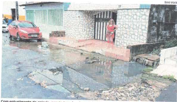
Com entupimento de galeria, esgoto transborda e prejudica moradores do Sacavém com odor fétido
